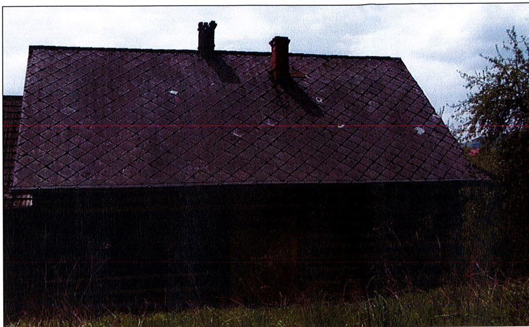
Rys. 5. Zdjęcie obrazujące wykorzystywanie wyrobów azbestowo-cementowych jako element pokrycia dachowego (płyty karo) źródło: zdjęcie własne – inwentaryzacja w terenie
