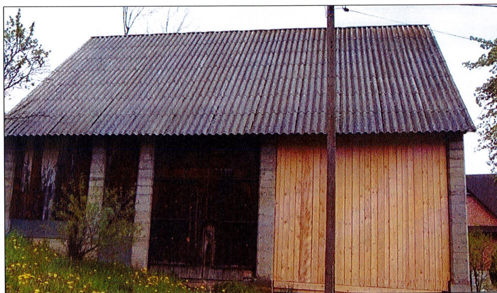
Rys. 6. Zdjęcie obrazujące wykorzystywanie wyrobów azbestowo-cementowych jako element pokrycia dachowego (eternit falisty), źródło: zdjęcie własne – inwentaryzacja w terenie
